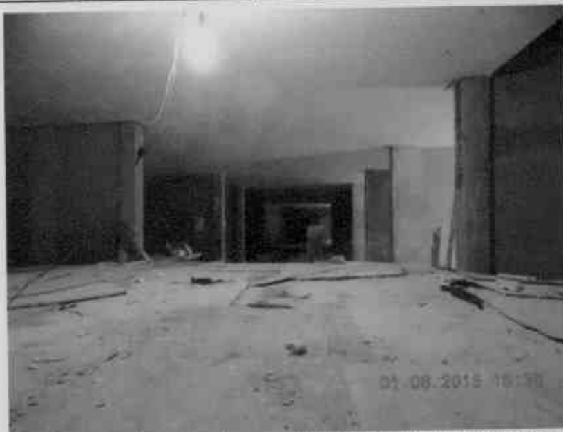
Figura 20 – Parte comercial com as obras em andamento, atualmente uma cooperativa contratou outra construtora para conclusão das obras.
